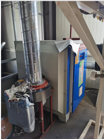
废气处理设施 (UV 光氧+活性炭一体机)
