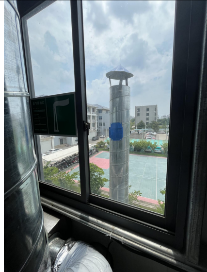
有组织废气排气筒 (FQ-1)
